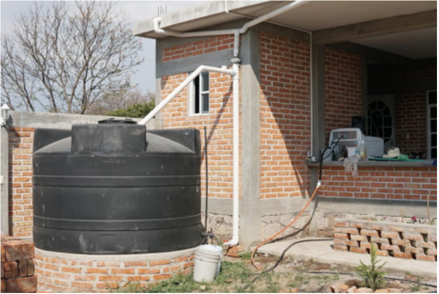
Sistema de captación de lluvia de 5,000 litros de capacidad en Agustín González. Mayo, 2019.
